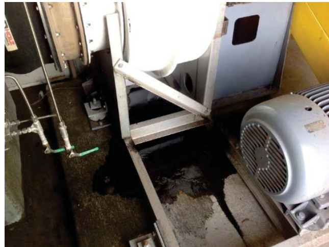
Odor Control Fan 1
